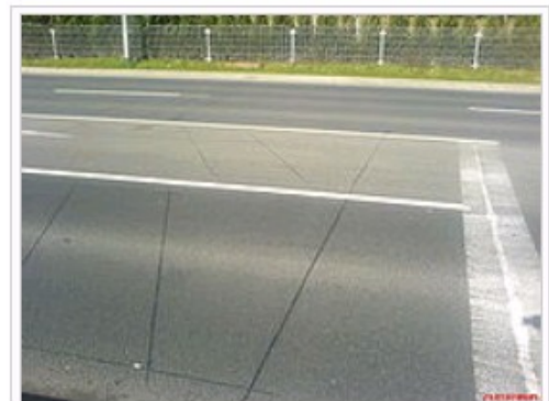
Induktionsschleife im Asphalt
